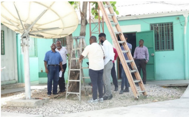
الشكل 23. تعزيز النفاذ إلى البيانات: تركيب نظام GEONETCast في هايتي
